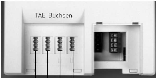
TK-Anlage mit geöffnetem Anschlussfeld
